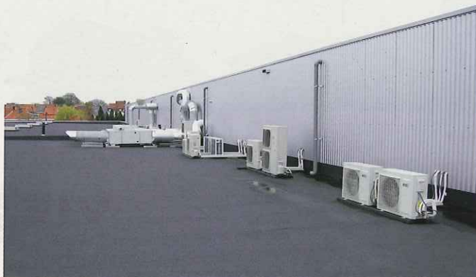
De HVAC installatie werd door het eigen personeel uitgevoerd, op basis van een studie in samenwerking met het De Nayer Instituut .
